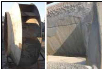
Build-up on fan blades.
